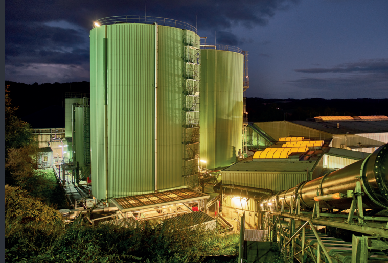
AVEA Entsorgungszentrum Leppe Lindlar – Vergärungsanlage
